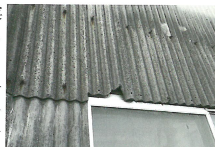
アスベスト含有の波型スレート
