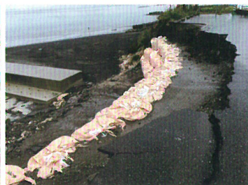
長沢の国道134号線の擁壁崩れ
