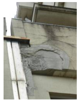
鉄筋が露出した外壁面
